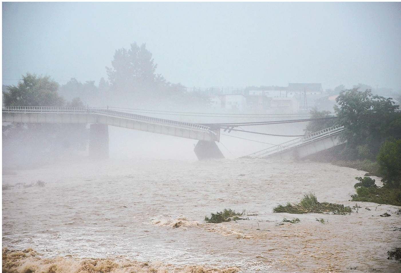
雨の影響で増水した濁川で一部が崩落したJR磐越西線の鉄橋
